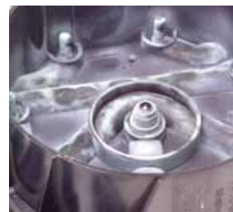
Bornes de laiton corrodées
